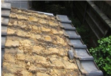
瓦の下に葺き土があり、瓦も経年劣化でもろくなり割れたり欠けたりしています。
