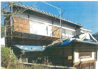
風雨にさらされ、外壁の杉皮がぼろぼろになっています。劣化した杉皮の張り替えを行います。
