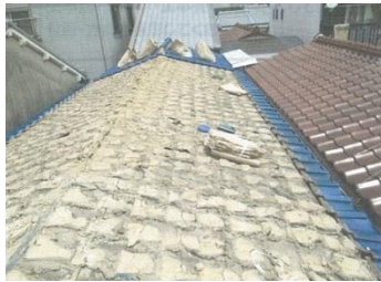
瓦の葺き土が一面に載っています。これを降ろすだけでも軽量化になります。
