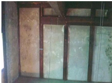
主に経年劣化で土壁が傷んでいます。劣化部を含め周辺まで修繕します。
