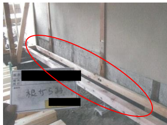
柱や土台の根継や入れ替えをして健全化した後に、柱の足元に根がらみ・足固めを施工します。
