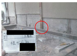
柱の足元に何も付いておらず、このままでは地震時の揺れによって柱がばらばらの方向に動きます。
