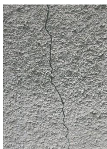
経年劣化でひび割れや腐食が。建物内部に悪影響を及ぼします。
