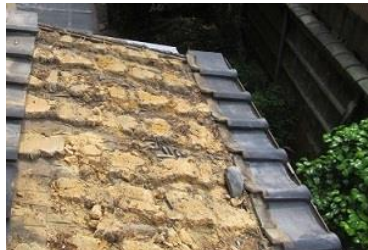
瓦の下に葺き土があり、瓦も経年劣化でもろくなり割れたり欠けたりしています。
