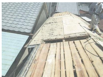
屋根の下地を調べてみれば、こんな構造になっています。
