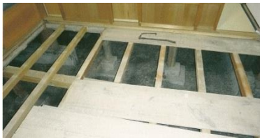
無筋の基礎やコンクリートブロック基礎のままでは耐震性UPにはなりません。
