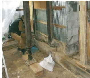
傷んだ部分を除去して、健全な土台や柱に入れ替えます。
