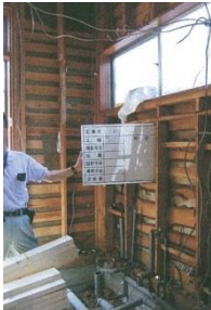
耐震壁は、すまいの耐力UPに重要な要素です。ただし、バランスよく！！
