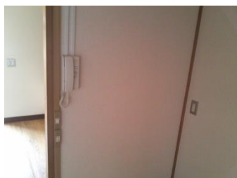
<居間・緊急通報装置>
