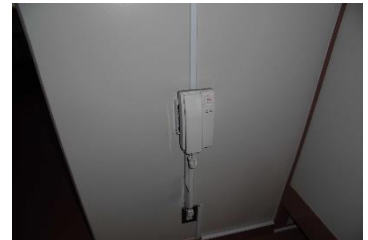
〈緊急通報装置〉
