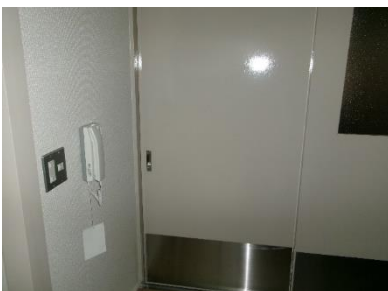
<居間・緊急通報装置>
