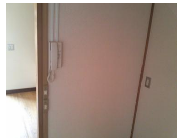
<居間・緊急通報装置>
