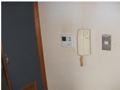
＜緊急通報装置＞
