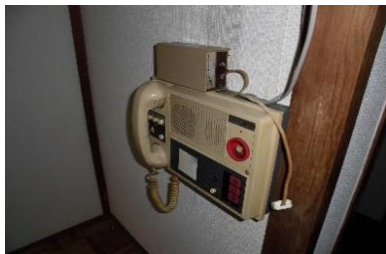
＜居間・緊急通報装置＞
