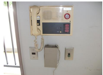
＜緊急通報装置＞
